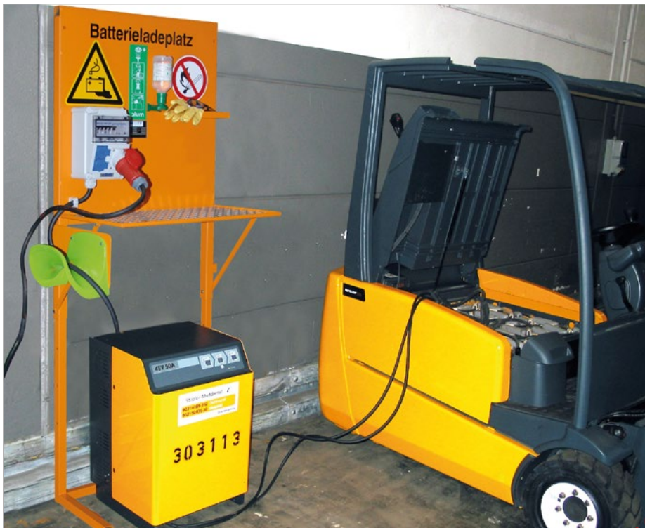
L met CEE krachtstroom-stopcontact 400 V, bij het opladen van een electro-heftruck
